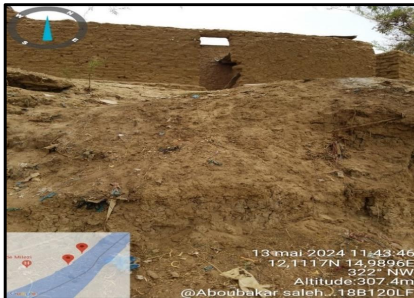
Photo 7 : Maisons en briques de terre vulnérables à l'érosion
