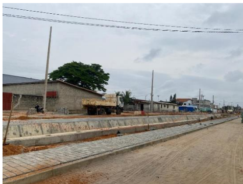
Photo 2b : Nouvelle voie et collecteur d'eau pluviale dans le 4 ème arr de Cotonou (quartier Sodjatimin centre)
