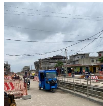
Photo 2c : Nouvelle voie et collecteur d'eau pluviale dans le 2 ème arr de Cotonou (quartier Yénawa)
