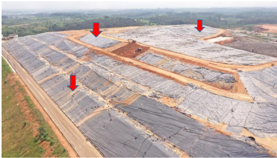
Photo 1 : Vue aérienne de déchets compactés et couverts
