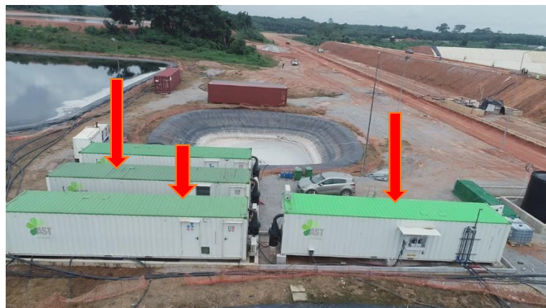
Photo 4 : Aperçu de conteneurs de traitement des lixiviats par Osmose inverse
